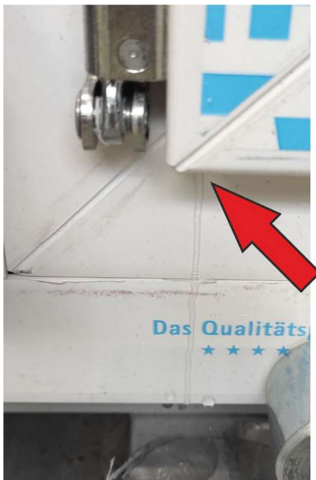
zaobserwowane miejsce przecieku
