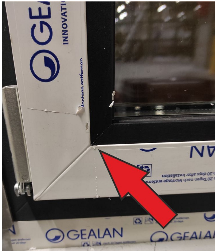
zaobserwowane miejsce przecieku
