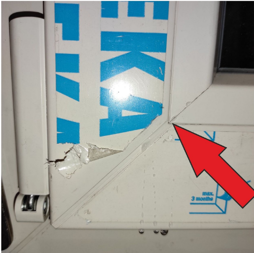
zaobserwowane miejsce przecieku
