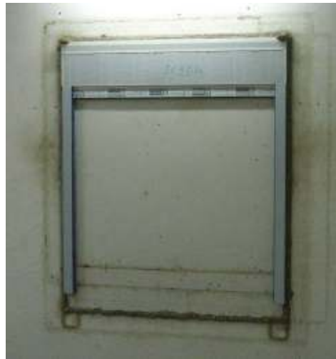
Ansicht vom Senderraum
